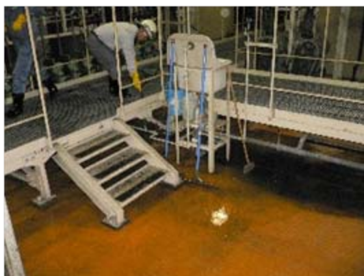
図2 塩酸供給ポンプ
